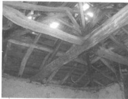
Charpente en croix. Fournière de Lousteauneuf avant rénovation.
